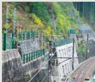
【落石止擁壁と落石警報装置】
