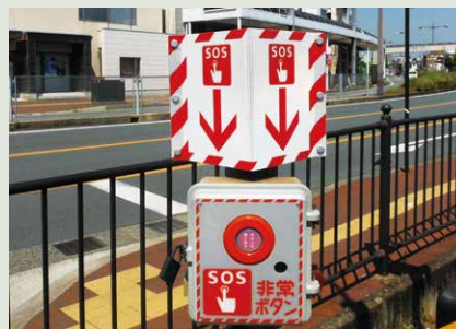
【非常ボタン（踏切支障報知装置）】
