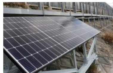
新幹線のり面を活用した 太陽光発電（試験設置）
