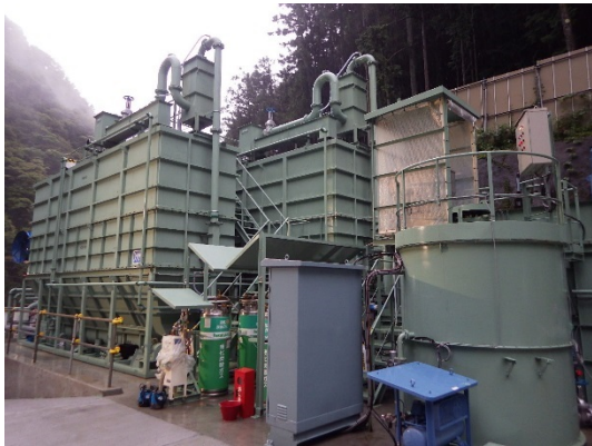
写真4-1-2-9 濁水処理設備設置状況 (早川非常口)
