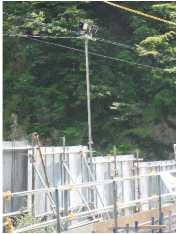
写真4-1-2-15 照明の漏れ出しの抑制 (早川非常口 LED照明点灯前)
