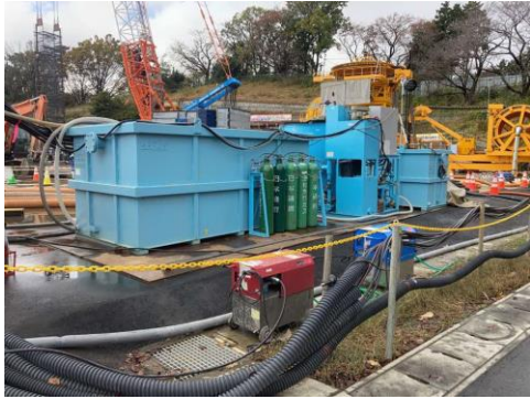
写真-1 濁水処理設備の設置（地点 01）
