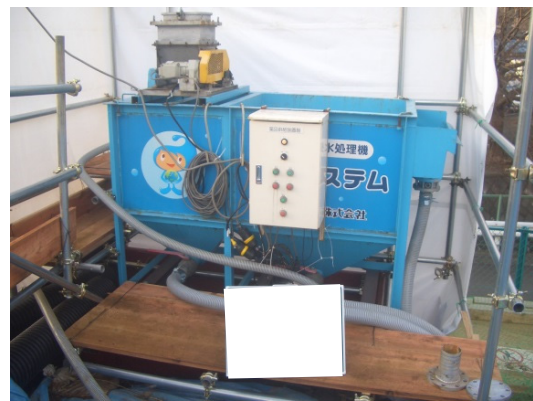
写真4-1-4-6 工事排水の適切な処理、濁水処理施設及び仮設沈砂池の設置
