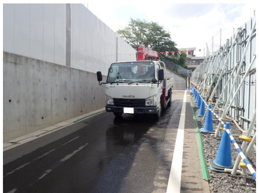
写真4-1-4-9 外来種の拡大抑制、資材及び機械の運搬に用いる車両の出入口、周辺道路の清掃及び散水、タイヤの洗浄
