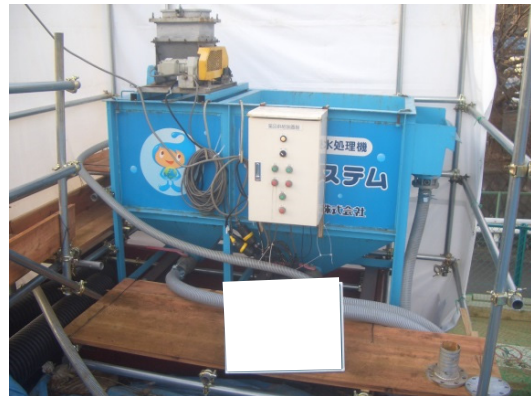
写真4-1-3-6 工事排水の適切な処理、 濁水処理施設及び仮設沈砂池の設置
