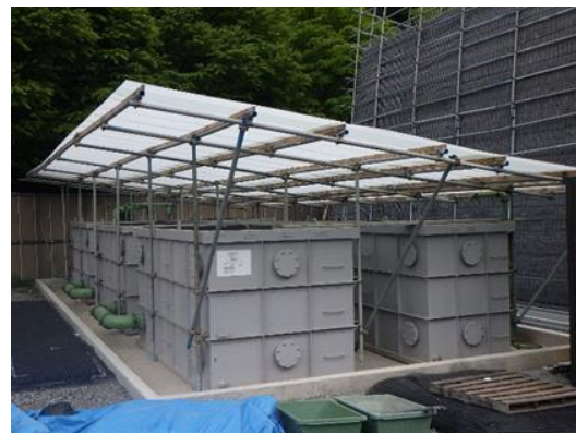
図 1 7 浸潤水の集水設備
