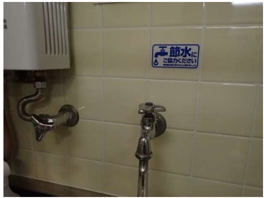
写真 5-1-9 使用水量の節約状況
