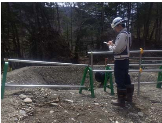
写真 5-1-8 処理設備の点検状況 (一例)
