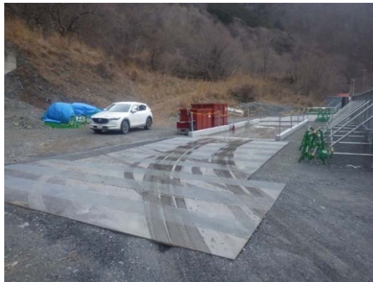
写真 5-1-12 タイヤ洗浄設備の設置状況 (一例)
