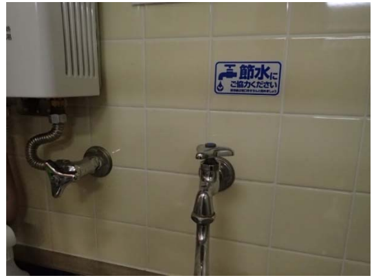
写真 5-1-9 使用水量の節約状況 (一例)
