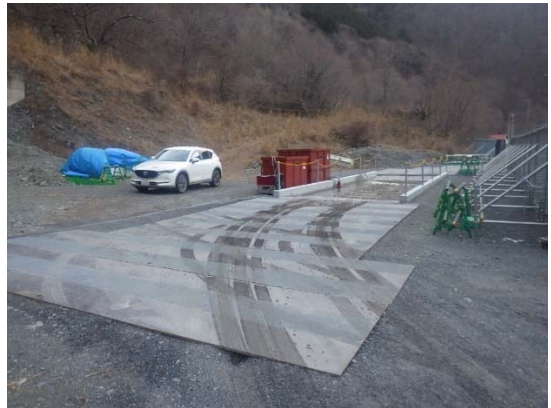
写真 4-1-9 タイヤ洗浄設備の設置状況 (一例)
