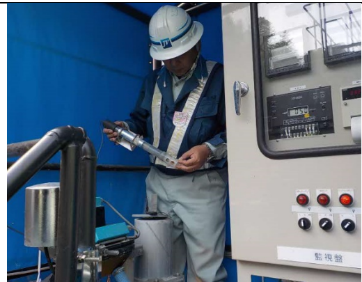
写真4-1-32 濁水処理設備の整備状況
