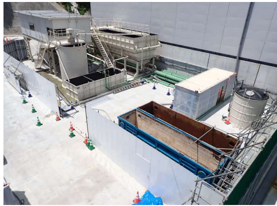
写真4-1-100 濁水処理設備の設置状況
