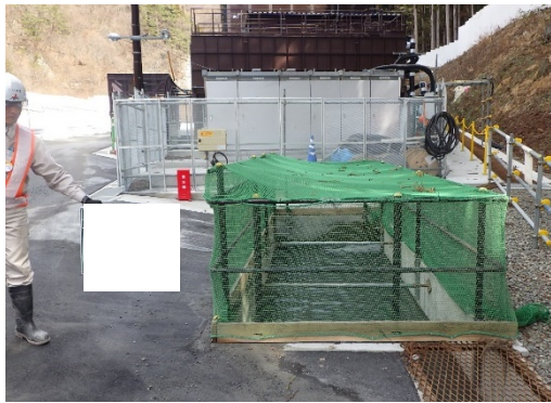
写真4-1-7 濁水処理設備の設置状況
