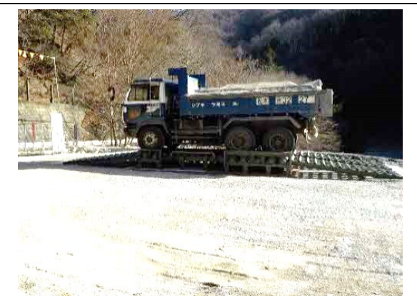
写真4-1-138 タイヤ洗浄装置の設置状況
