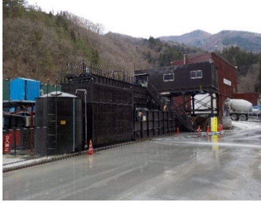
写真4-1-29 濁水処理設備の設置状況
