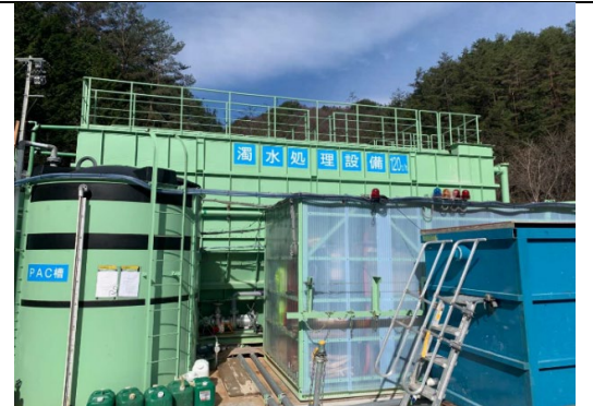
写真4-1-50 濁水処理設備の設置状況
