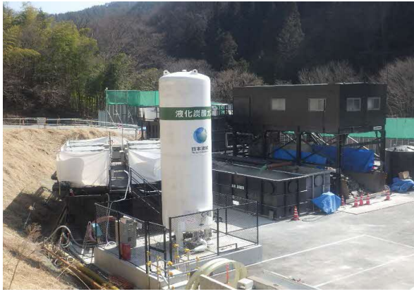
写真4-1-68 濁水処理設備の設置状況
