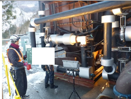
写真4-1-10 濁水処理設備の整備状況
