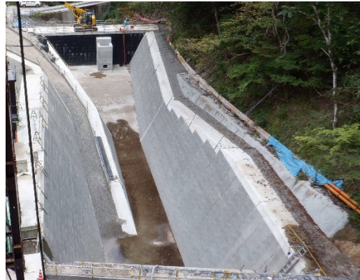
写真4-1-132 排水設備の設置状況
