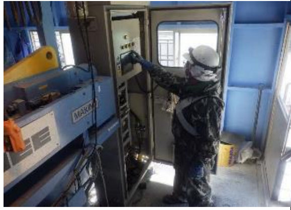
写真4-1-69 濁水処理設備の整備状況
