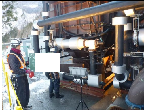
写真4-1-10 濁水処理設備の整備状況 (一例)
