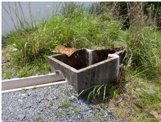
写真4-1-93 排水処理の状況 （一例）
