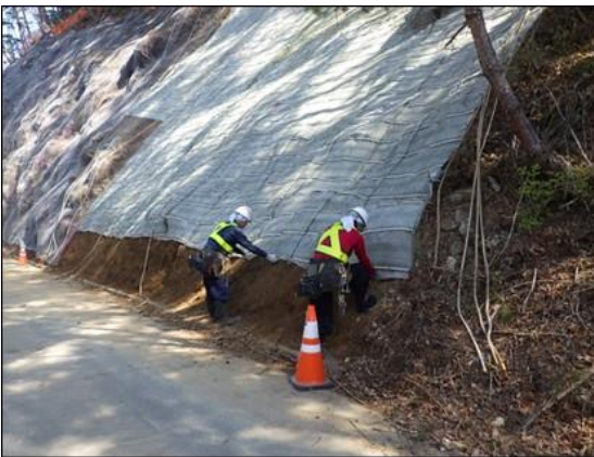
写真4-1-42 法面、斜面の保護、切土法面 等の緑化による植生復元の状況 (一例)
