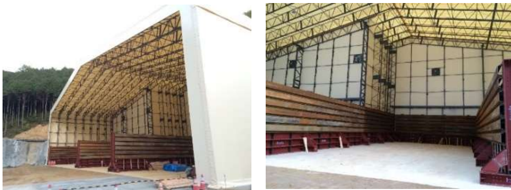
重金属等判定用土砂ピット例
