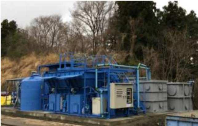
① 濁水処理設備（トンネル工事施工ヤードに設置）の例
