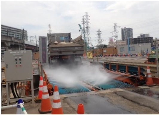
写真4-1-6-9 資材及び機械の運搬に用いる車両の出入り口等の 清掃、散水及びタイヤの洗浄
