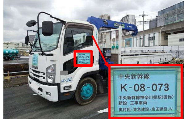
写真4-1-6-10 工事に使用する道路、 搬入時間及び法定制限速度の遵守 (車両標識明示による安全運転意識の向上)
