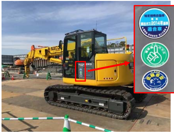
写真 4-1-3-1 排出ガス対策型建設機械の採用 低騒音型建設機械の採用
