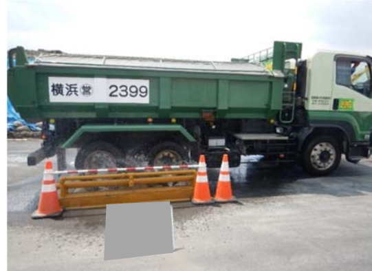
写真 4-1-2-11 資材及び機械の運搬に用いる車両の 出入口等の清掃、散水及びタイヤの洗浄
