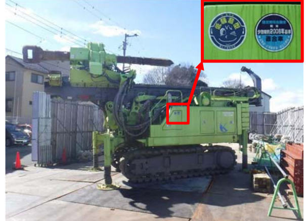
写真 4-1-5-2 排出ガス対策型建設機械の採用 低騒音型建設機械の採用
