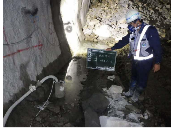
排水処理状況
