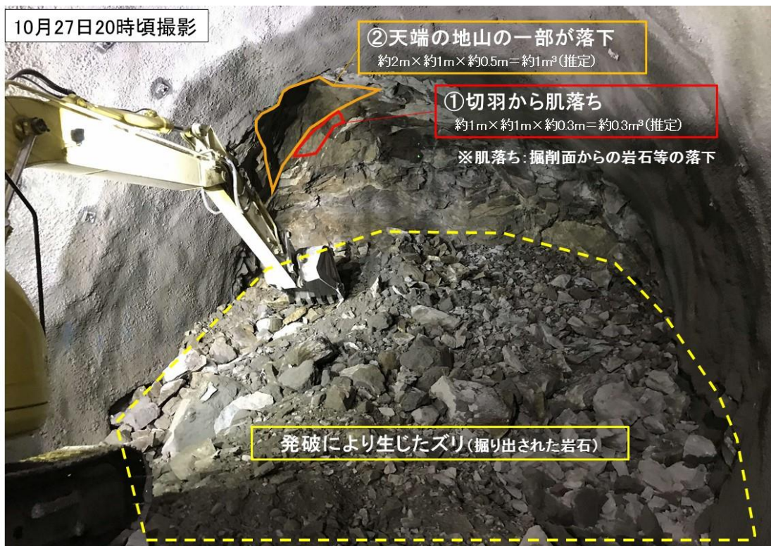
図1-1 災害現場の状況（令和3年10月27日 現在）
