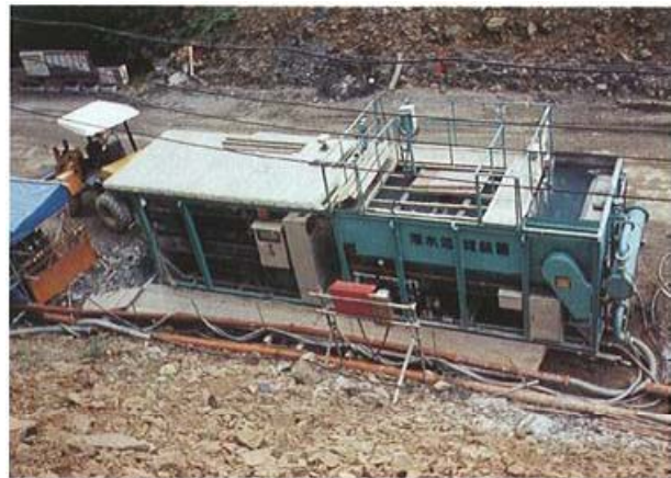
濁水処理施設
