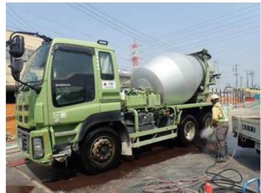
写真 4-1-4-6 資材及び機械の運搬に用いる車両 の出入口、周辺道路の清掃及び 散水、タイヤの洗浄
