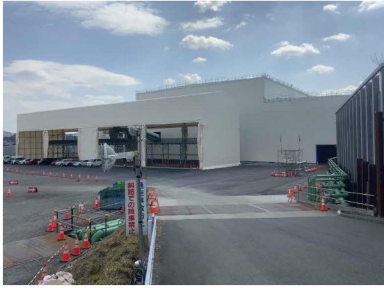
写真 4-1-2-1 仮囲い・防音シート等の設置状況 (防音ハウスの設置状況)
