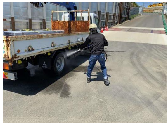
写真 4-1-2-6 資材及び機械の運搬に用いる車 両の出入口、周辺道路の清掃及び 散水、タイヤの洗浄
