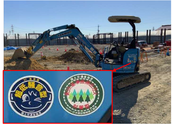
写真4-1-2-2 排出ガス対策型建設機械の採用 低騒音型建設機械の採用
