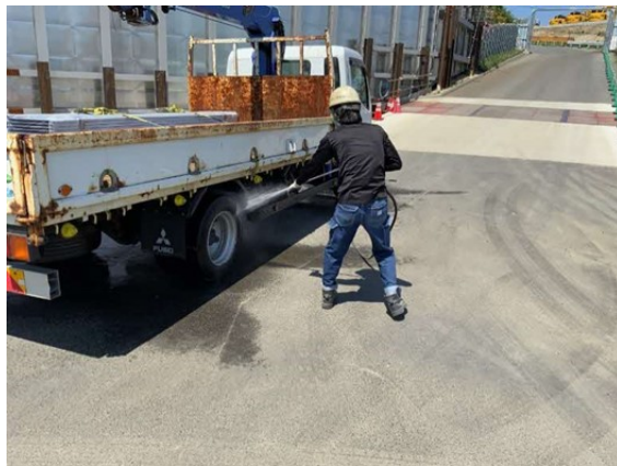
写真4-1-2-5 資材及び機械の運搬に用いる車両の出入口、周辺道路の清掃及び散水、タイヤの洗浄
