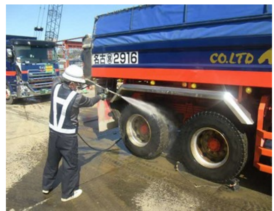
写真4-1-3-6 資材及び機械の運搬に用いる車両の出入口、周辺道路の清掃及び散水、タイヤの洗浄
