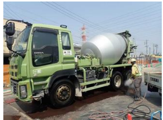
写真4-1-5-6 資材及び機械の運搬に用いる車両の出入口、周辺道路の清掃及び散水、タイヤの洗浄
