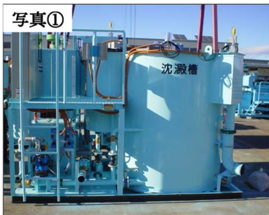
濁水処理設備 (工事施工ヤード内に設置)
