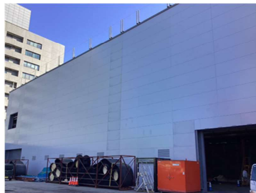
写真② 防音ハウス
