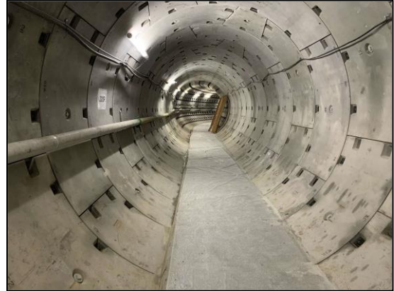
写真 3-2-3-1(4) 名城変電所（電気洞道）
