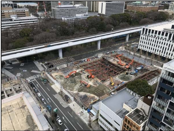
写真 3-2-3-1(3) 名城変電所（全景）
