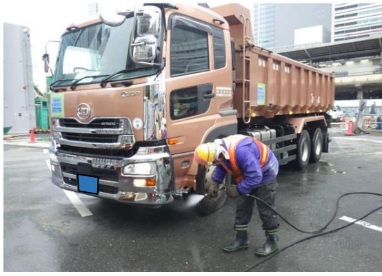
写真 7-1-3-7 資材及び機械の運搬に用いる車両の出入口、周辺道路の清掃及び散水、タイヤの洗浄
