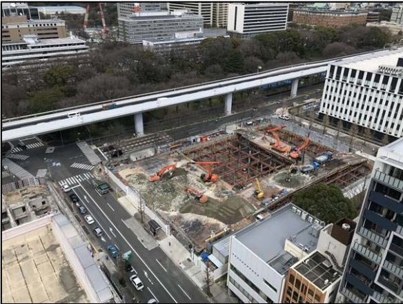
写真 3-2-3-1(3) 名城変電所（全景）
