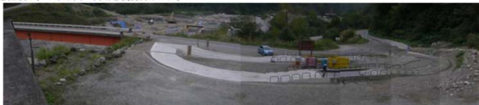
写真-2 タイヤ洗浄装置（全景）
