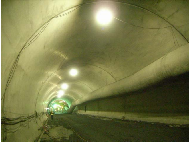
図 7-5-6 覆エコンクリートの施工例（一般県道 常神三方線 神子トンネル） （福井県 敦賀土木事務所 道路改良主要事業 ホームページより抜粋）
