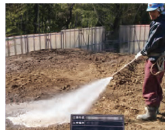
工事現場における散水の例 日建連「建設工事における環境保全活動事例集 40 粉じん対策」より
