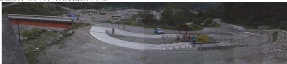
写真2 タイヤ洗浄装置（全景）
