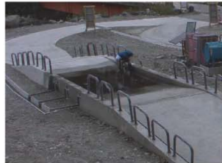
写真4 普通車用 洗浄プール
