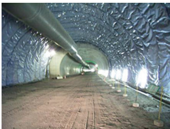
適切な構造の採用（防水シート）の例 「国土交通省 中国地方整備局 山口河川国道事務所HP」より
