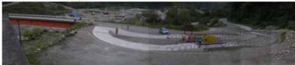
写真2 タイヤ洗浄装置（全景）
