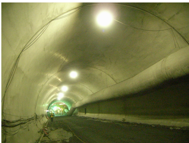
図 7-5-6 覆工コンクリートの施工例（一般県道 常神三方線 神子トンネル） （福井県 敦賀土木事務所 道路改良主要事業 ホームページより抜粋）
