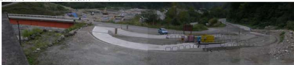
写真2 タイヤ洗浄装置（全景）
