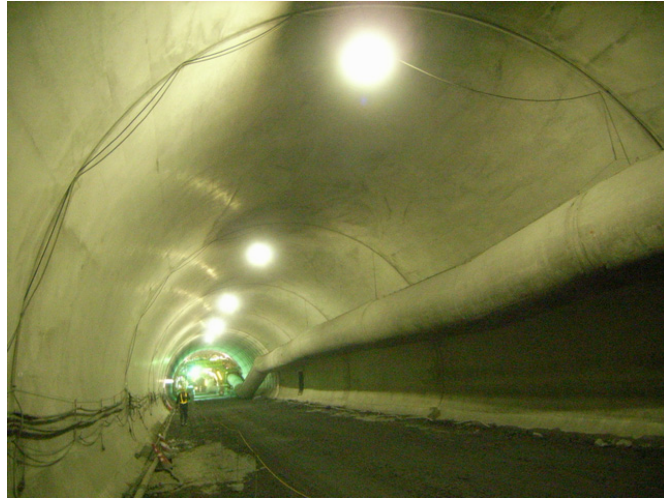
図 7-4-6 覆エコンクリートの施工例（一般県道 常神三方線 神子トンネル） （福井県 敦賀土木事務所 道路改良主要事業 ホームページより抜粋）
