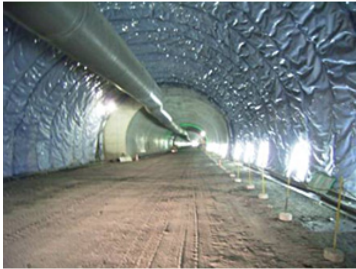
図 7-4-5 防水シートの施工例（一般国道 191 号線 萩・三隅道路） （国土交通省 中国地方整備局 山口河川国道事務所ホームページより抜粋）
