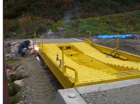
写真-3 大型車両用 洗浄ピット装置
