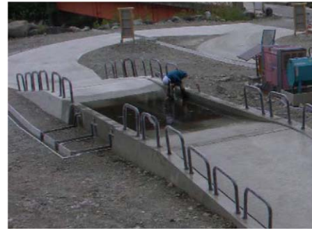
写真-4 普通車用 洗浄プール
