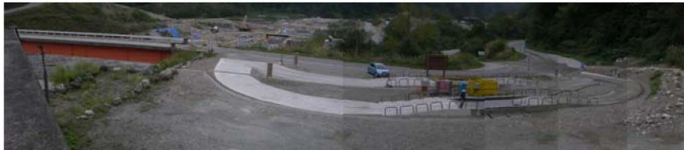
写真-2 タイヤ洗浄装置（全景）
